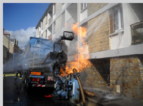
Trancheuse en feu suite à l'endommagement d'un réseau de distribution de gaz
