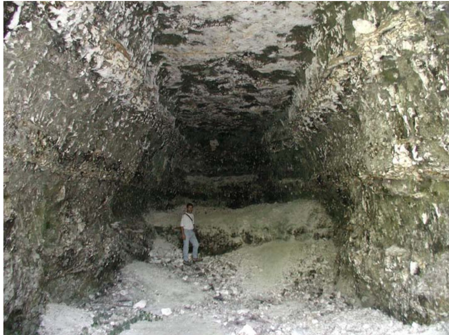
Illustration 15 - Entrée d'une carrière souterraine, dont seul les 20 premiers mètres de galeries sont visibles suite à des effondrements (Bréchamps).
